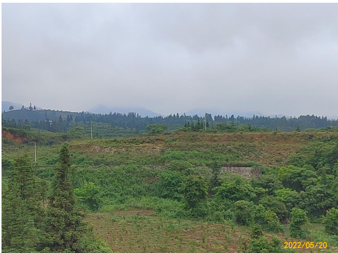
图9 道路工程区 K22+250 边坡防治效果
