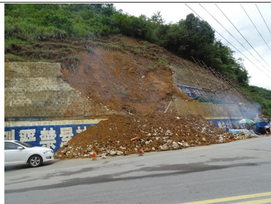
图 13 K17+180 路段边坡垮塌时情况
