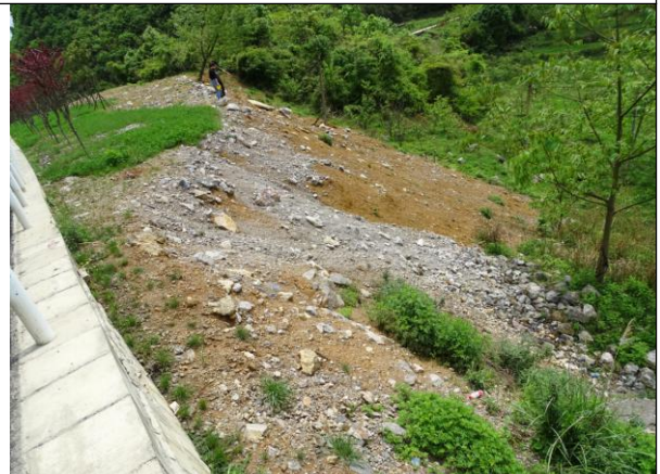
图 12 陡坡土石边坡未治理区域，属扰动加速侵蚀区域
