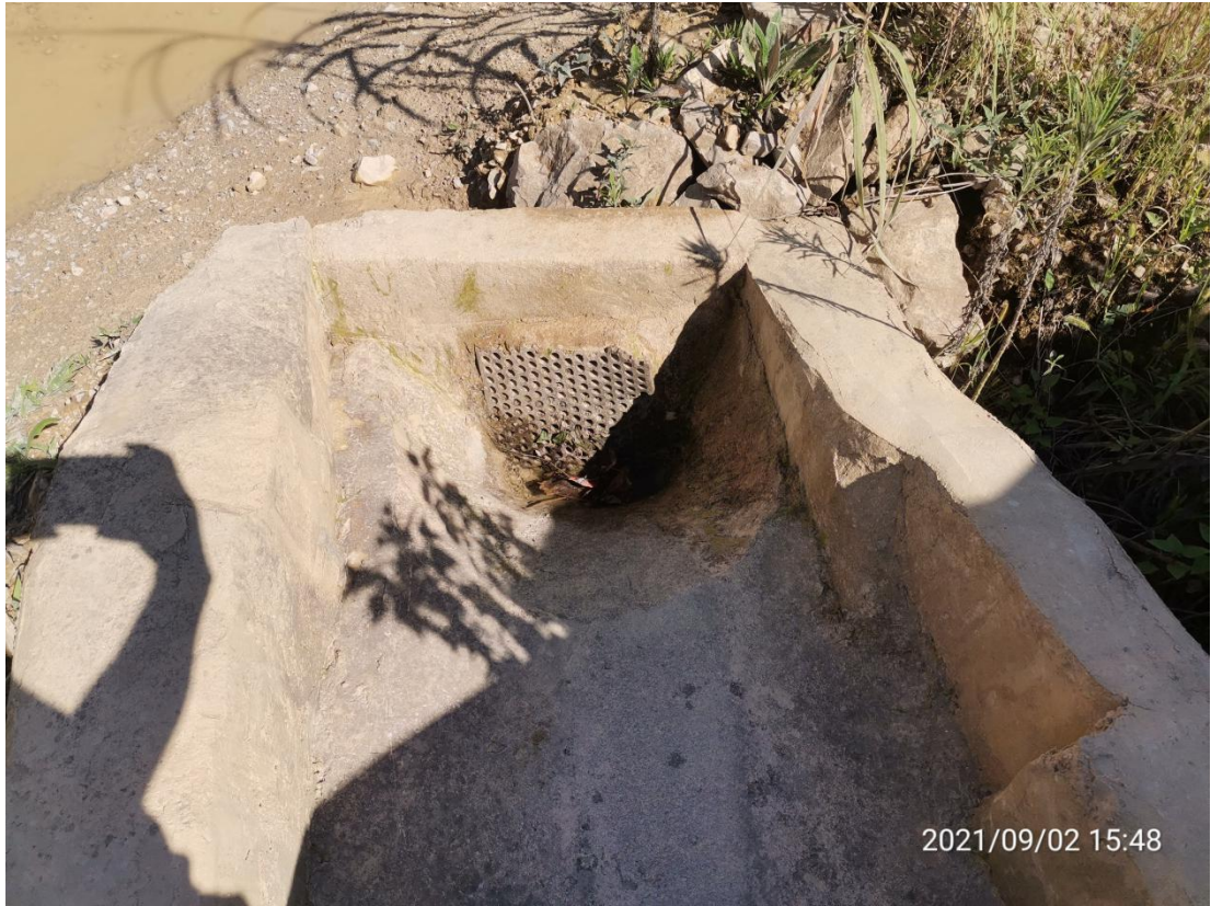
图3 排水沟及排水暗管
