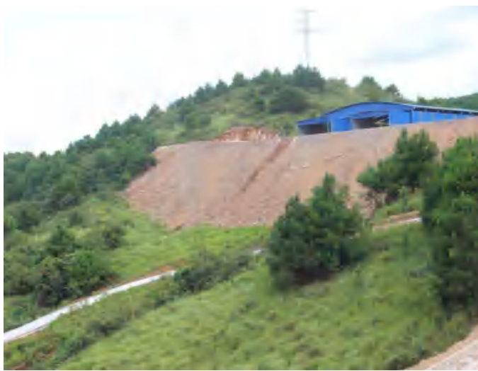
图 27 施工营地治理前
