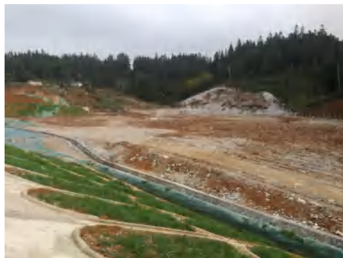
图 29 施工营地治理前
