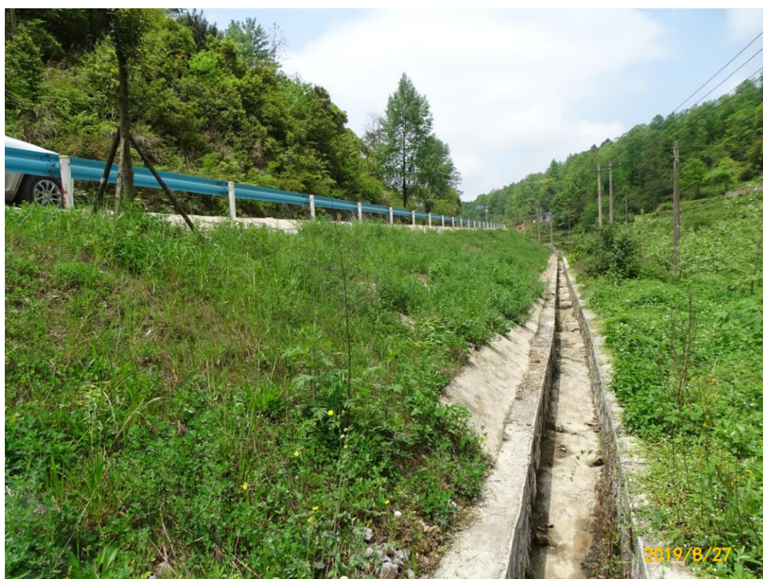
图 14 道路工程区 K13+300 道路左侧排水沟及是被恢复情况
