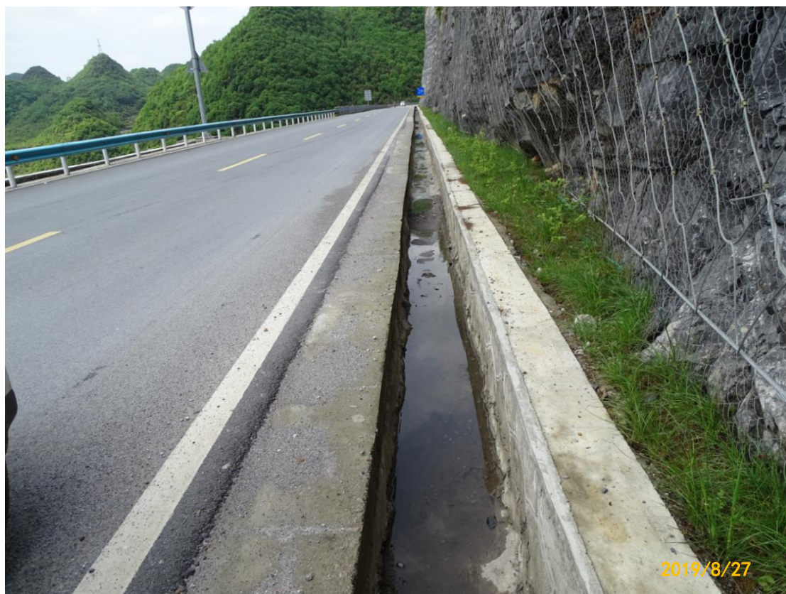
图 7 道路工程区 K7+100 道路右侧实施的排水沟
