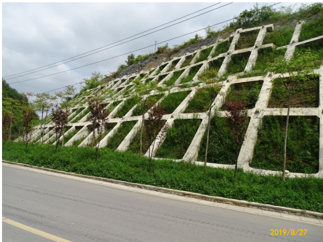
图 22 道路工程区 K22+250 边坡防治效果
