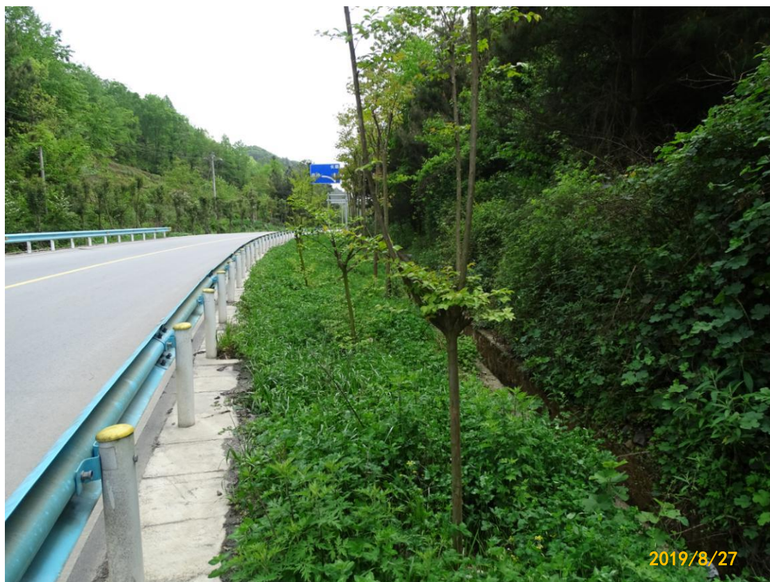
图 15 道路工程区 K15+650 道路左侧排水沟及是被恢复情况
